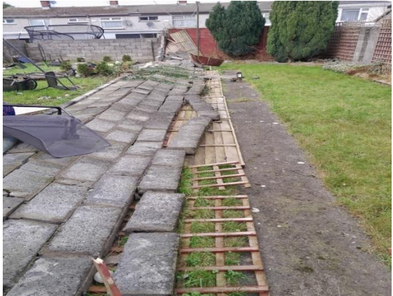
Storm Éowyn Damage
