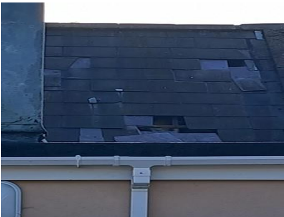
Storm Éowyn Damage
